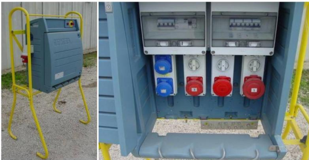
Figura 13 - Quadro elettrico da cantiere con un arrivo e tre partenze.
